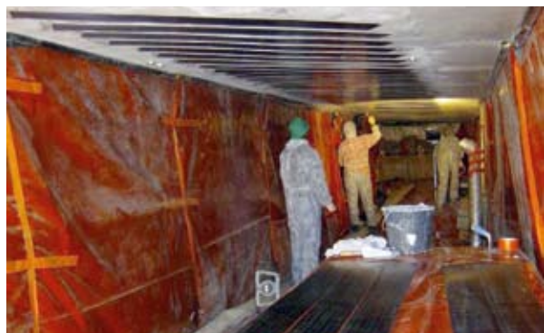
Photo 6 : pose des lamelles de fibre de carbone. Les conditions météo et hydriques n'étant pas bonnes (travaux effectués en hiver et ouvrage situé au-dessus d'une rivière) l'entreprise a travaillé dans « un tunnel » avec chauffage, tant pour le séchage de la résine que préalablement pour la mise en température du béton, plusieurs heures avant toute pose) – Source : Hervé Marneffe (CETE de l'Est)
