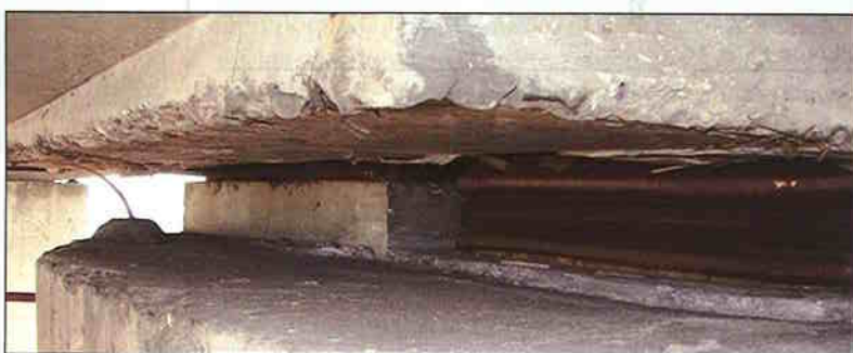
Photo 19 Vue sur un appui avec le calage de construction en charge sur les bossages de vérinage A support with the construction bracing under load on the jacking anchor blocks
